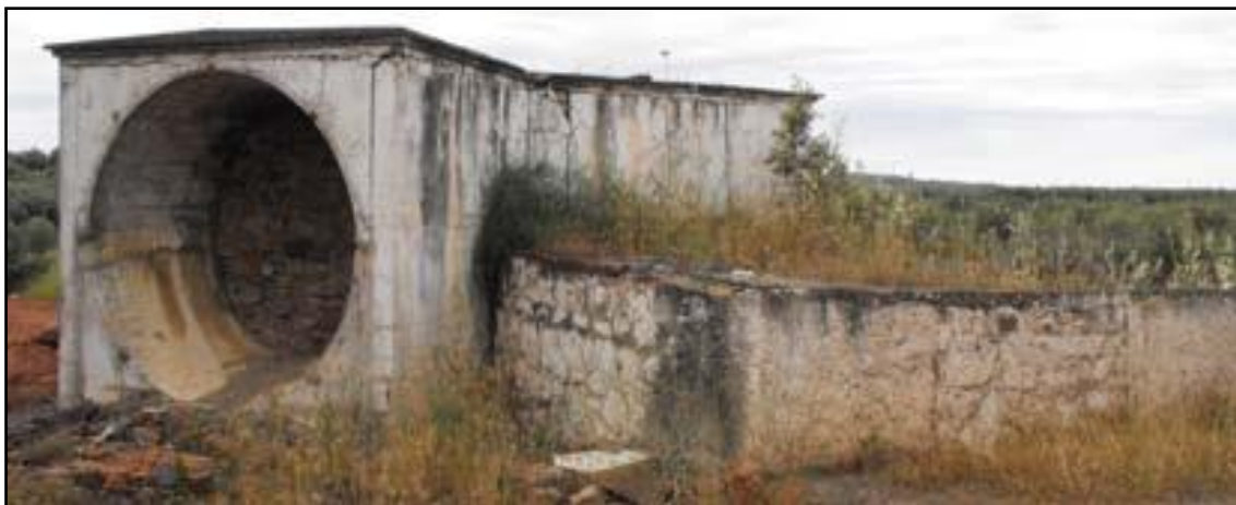
Fig. 2. Embocadura para ventilación . Imagen de los autores.
