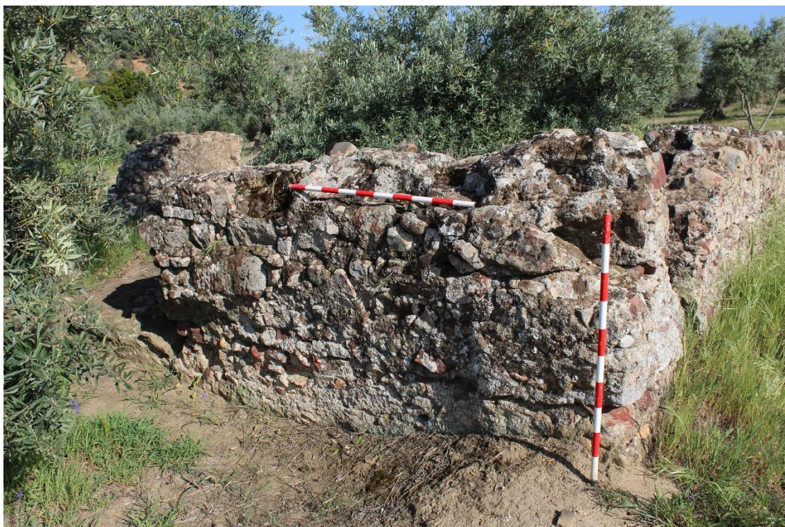
Fig. 4. Estructura hidráulica 2. Imagen de los autores.
